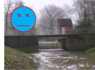
Fischbauchklappe St. 47+230 (Wehranlage Hs. Seppenhagen) Ahlen Nordwest
