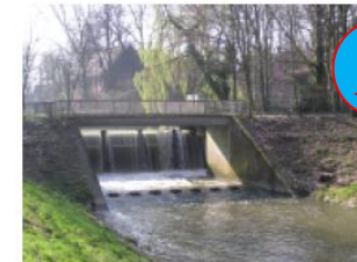
Fischbauchklappe St. 37+780 (Wehranlage Hs. Landsberg) Drensteinfurt
