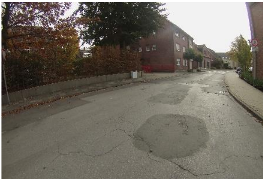
Abb. 3.6-7 Flächendeckende Oberflächenmängel des Fahrbahnbelags, Eickenbecker Straße (eigene Aufnahme)
